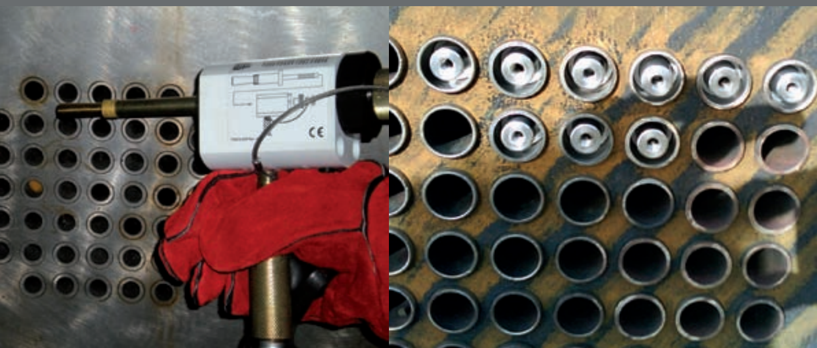
Obturateurs posés sur tubes d'échangeur
